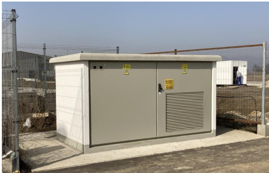
6. ábra: Betonházas transzformátorállomás
