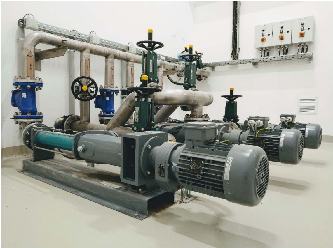
6. ábra: Fölősiszap szivattyú állomás
