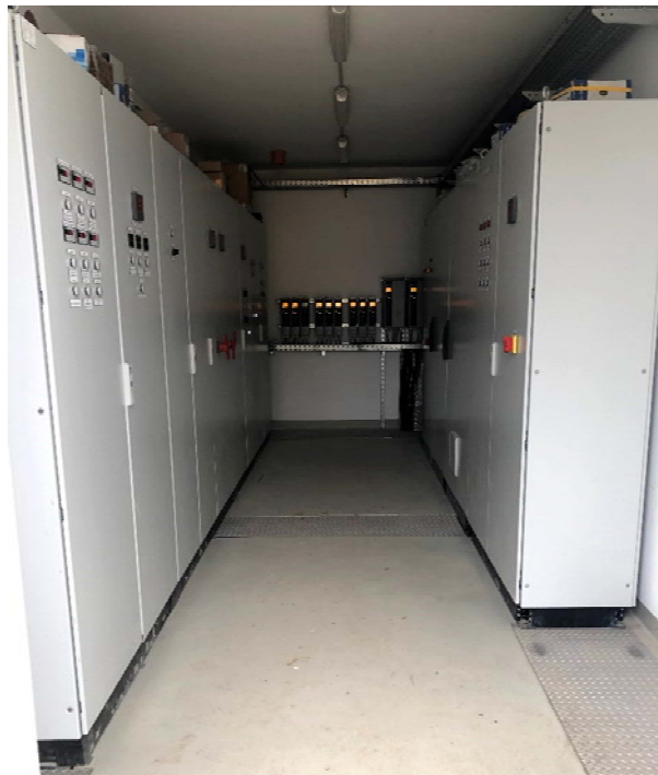
3. ábra: Villamos helyiség a technológiai épületben
