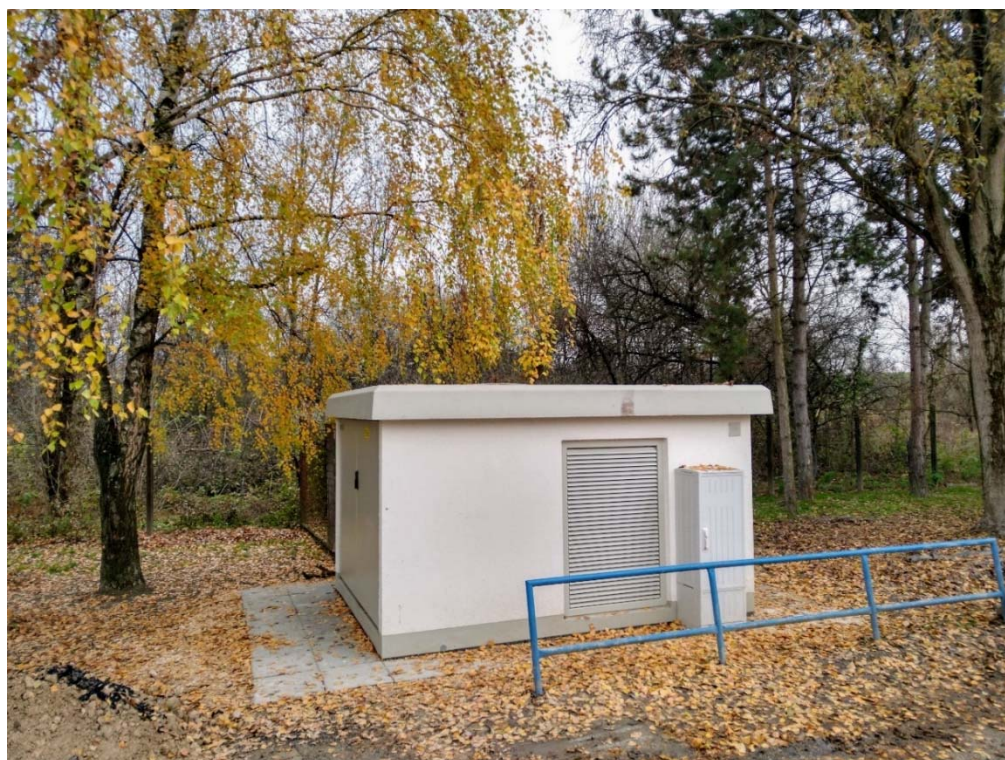
1. ábra: 1000 MVA teljesítményű új transzformátorállomás a komáromi szennyvíztisztító telep területén
