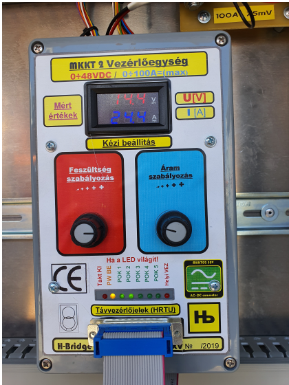
10.1. ábra Katódállomás vezérlő egysége (forrás: saját)
