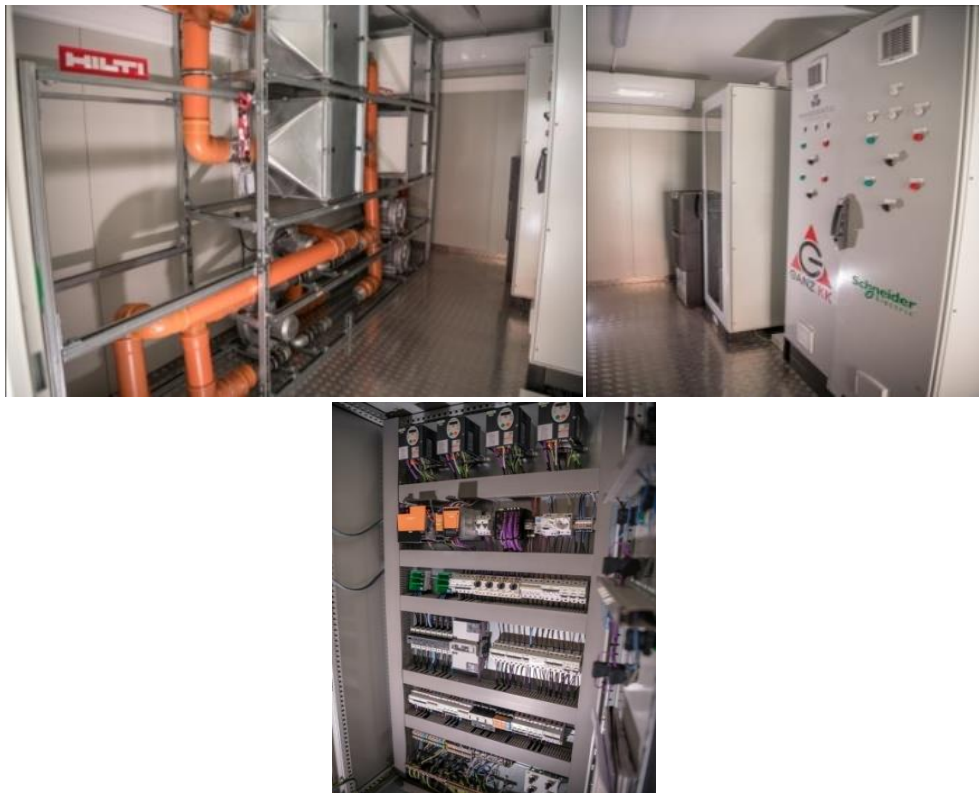
ábra 3.:A megvalósított központi levegőmenedzsment rendszer szűrőháza, valamint vezérlő egysége
