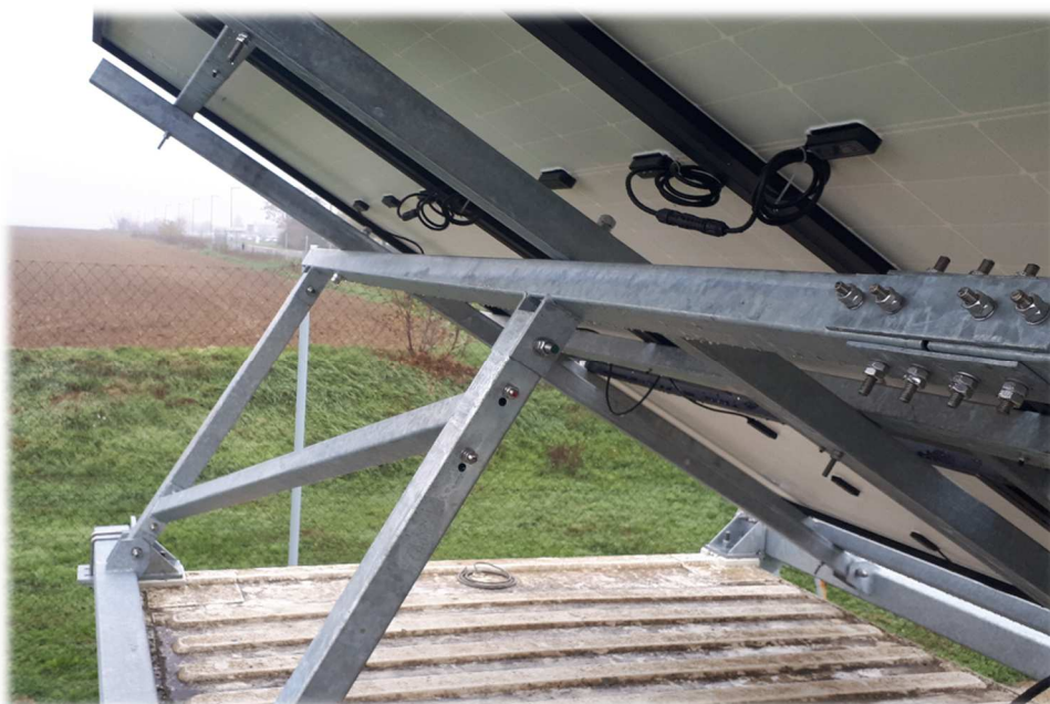
35. ábra PV panelek kábelezése 38
