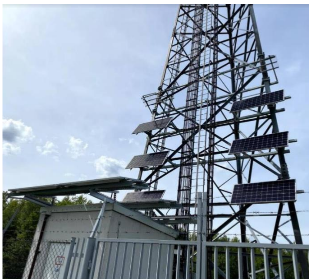
11. ábra. Vegyes telepítési megoldás: konténerre és toronyra. 15
