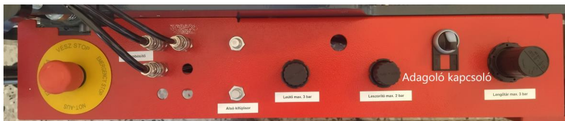
2.9. ábra - Adagoló kapcsoló [saját fotó]
