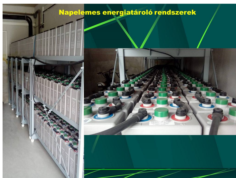
5.ábra: 30 kVA-es UPS akkumulátor telepe
