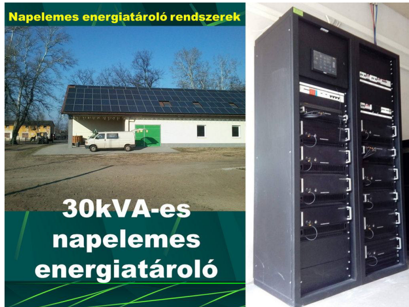
4.ábra: 30 kVA-es napelemes szünetmentes áramellátó rendszer
