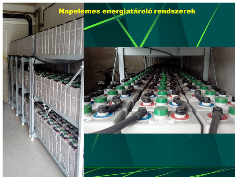
5.ábra: 30 kVA-es UPS akkumulátor telepe
