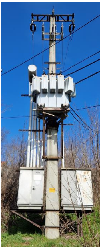
22. ábra Vízmű gépház elnevezésű OTR állomás (Forrás: saját fotó)
