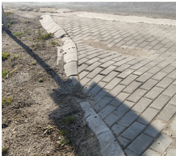
2-4. ábra Megrongálódott K-szegély a 68 sz. út mellett, Segesd (Forrás: saját készítésű kép)
