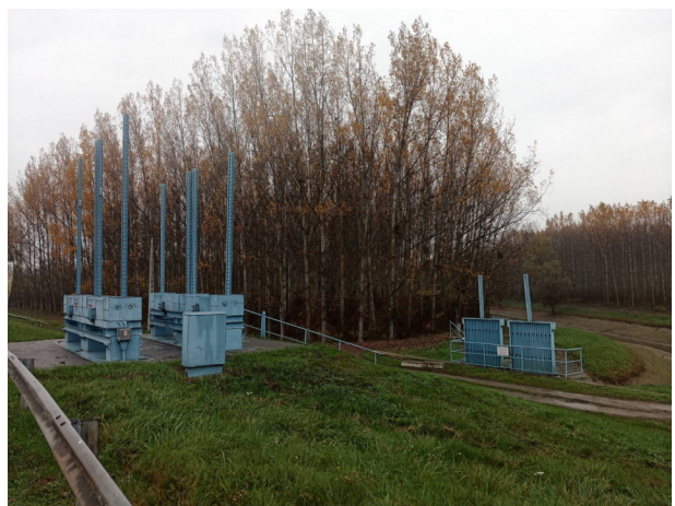
19. ábra. Zsilip az ártéri oldalon (saját fotó)
