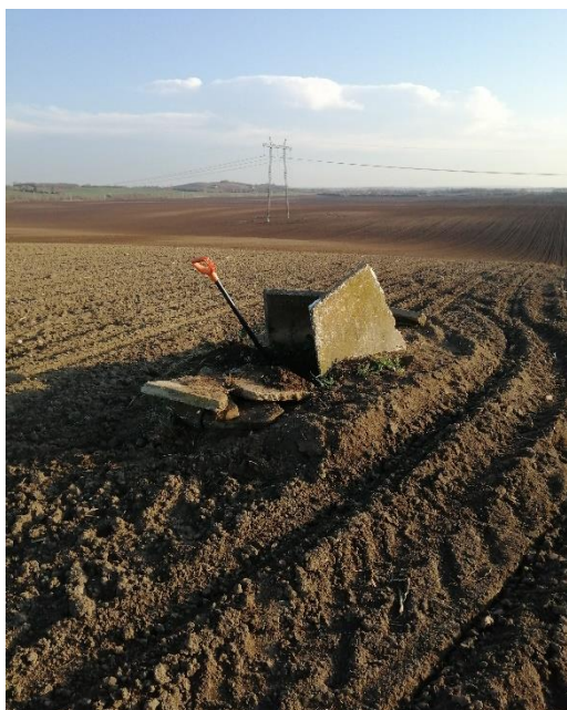
18. ábra 44-1101 pont pusztulása (Saját kép)
