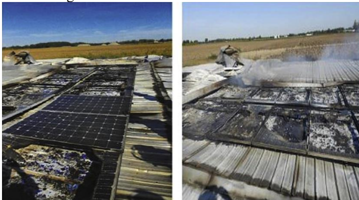
4. Ábra: Napelem panelek tűzkitörés utáni leégett állapotban [6].
