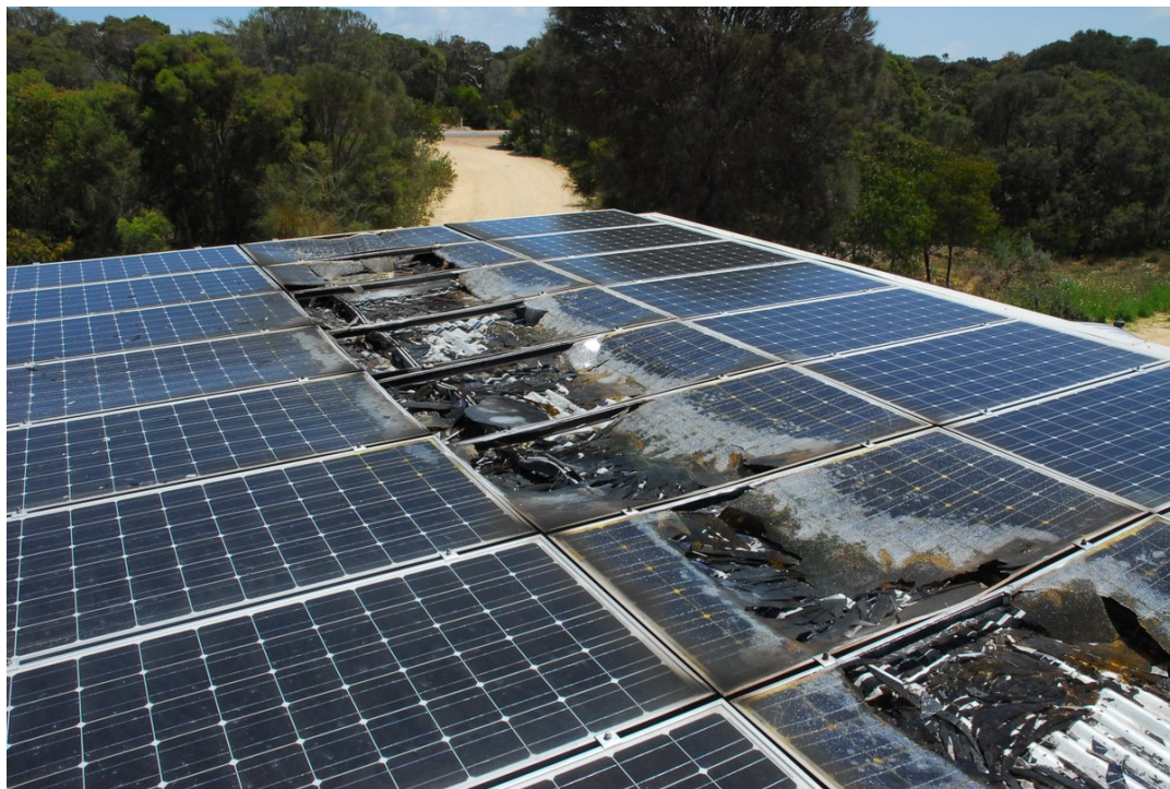
4. ábra: Tetőszerkezeten helyet kapó napelemes rendszer tüzeset után (Forrás: https://www.pv-magazine.com/wp-content/uploads/2020/11/fire-pic.jpg )
