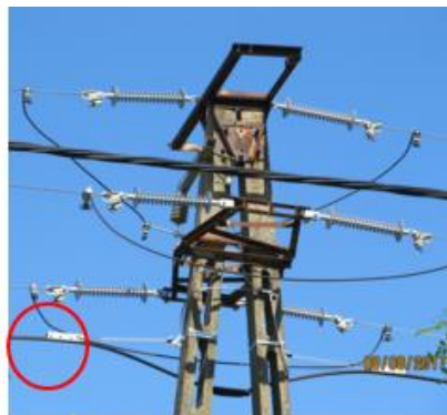
18. ábra Az optikai hálózat és az 5G antennák észrevétlenül elhelyezhetők a Tiszaalpár 20 kV hálózaton DÉMÁSZ hálózaton - Nemzeti Közművek [58]
