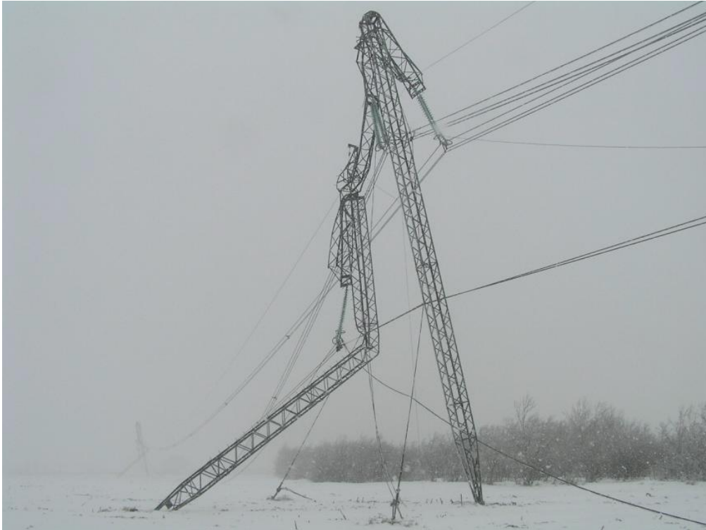
22. ábra. A Munkács-Sajószöged 400 kV-os kikötött portál oszlop károsodása [13]
