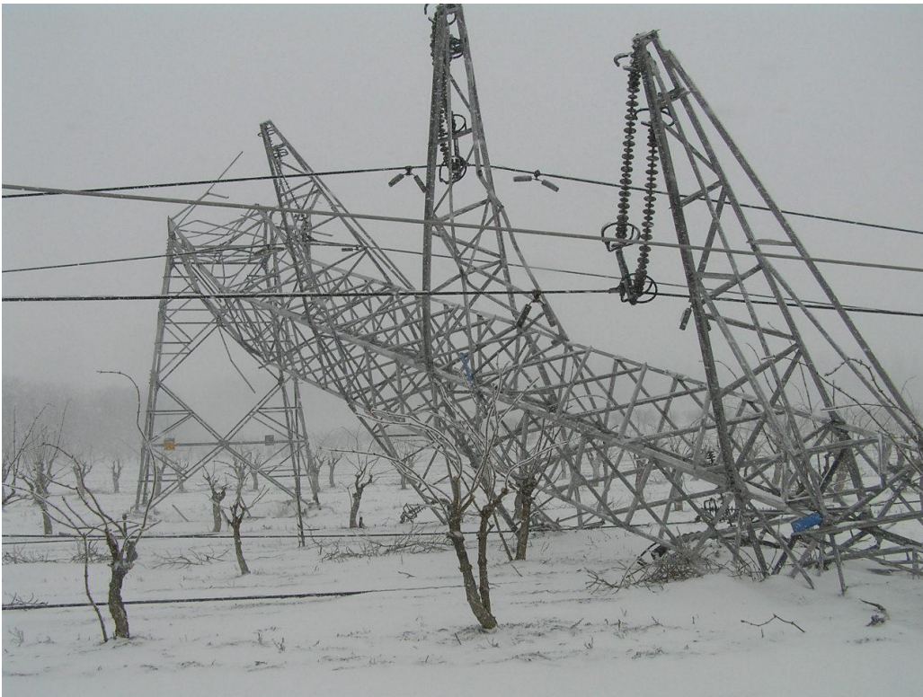
21. ábra. A Kisvárda-Sajószöged és Munkács-Tiszalök 220 kV-os, kéttrendszerű távvezetéken kidőlt oszlopok [13]
