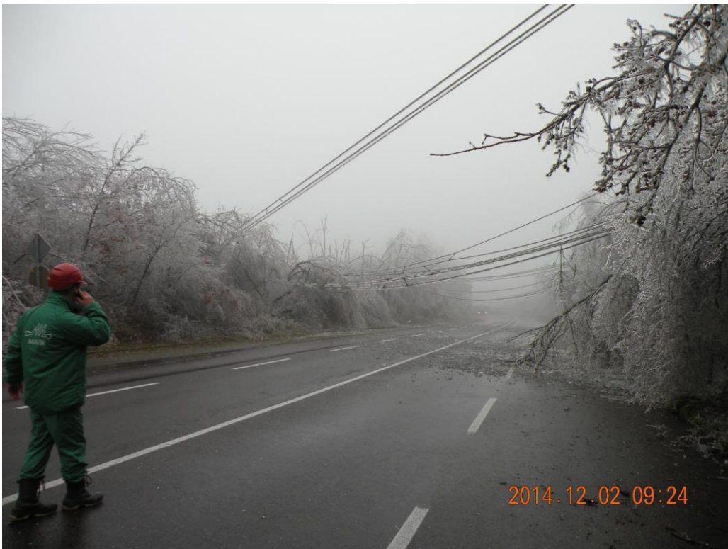
26. ábra. Az M31 autópályát keresztező oszlopközben a leszakadt sodronyok [16]
