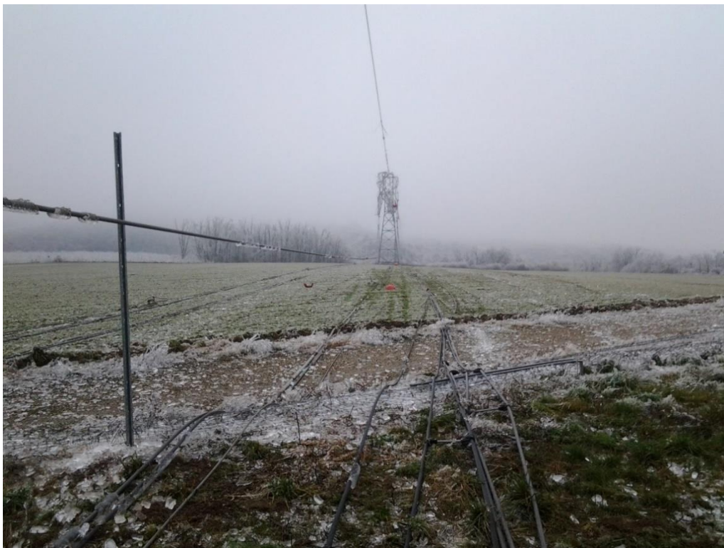
23. ábra. A leszakadt fázisvezető sodronyok [13]
