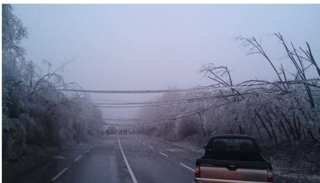
27. ábra. Az M31autópályát keresztező oszlopközben a leszakadt sodronyok [16]
