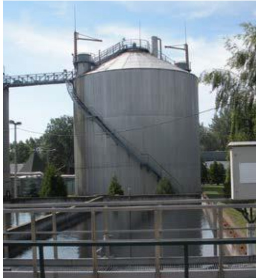
6. ábra Függőleges elrendezésű rothasztó torony egy szennyvíztelepen (Forrás: Saját kép)
